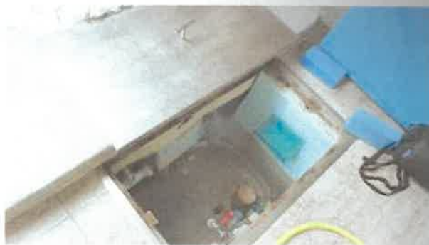
úpravňa vody bazénu
