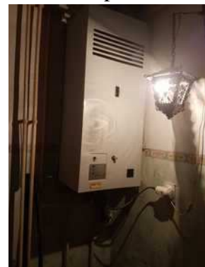
Plynový kotel na chodbě
