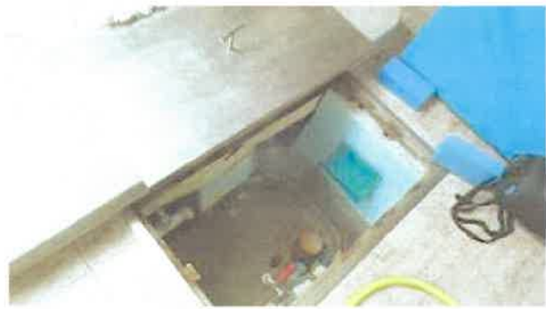
úpravna vody bazénu
